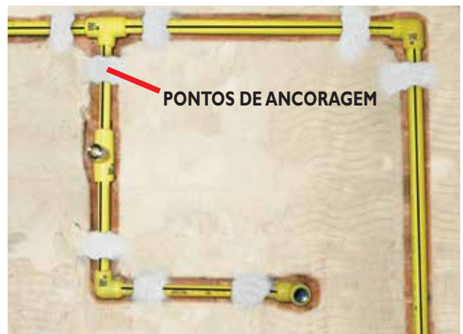
Vista parcial de instalação.
